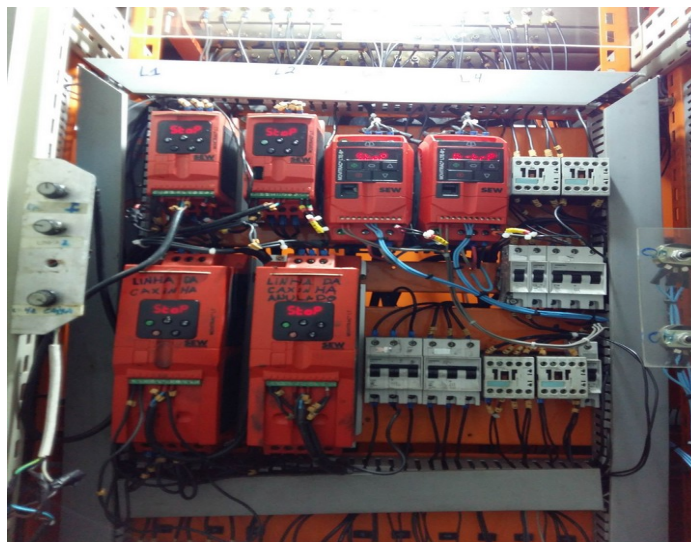
Figura 6 - Painel CCM-2 onde há a presença de vários inversores de frequência.
